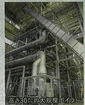
高さ30mの大規模ボイラー
